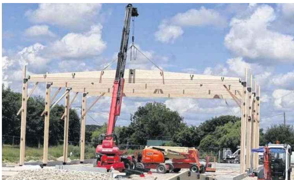
À Brou, la charpente de la salle multisport, route de Mottereau a pris place au cours de la semaine passée.
